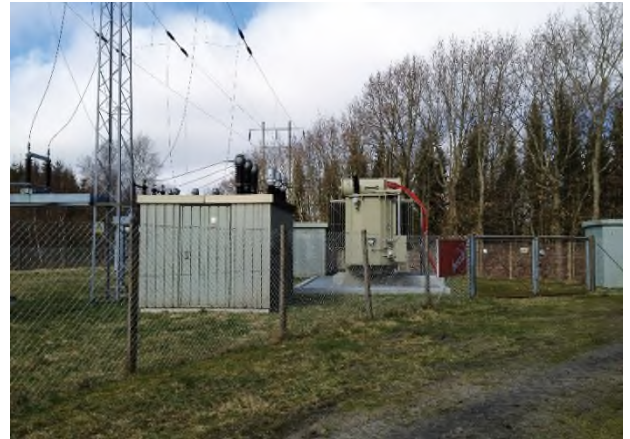
Figur 8. Eksempel på transformerstation.
