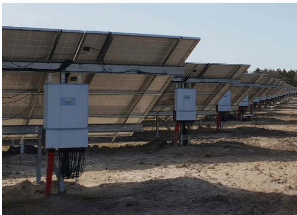
Figur 6. Invertere der sidder under solpanelerne.
