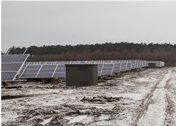
Figur 5. Transformer opstillet i forbindelse med solceller på den nedlagte flyveplads i Vandel.
